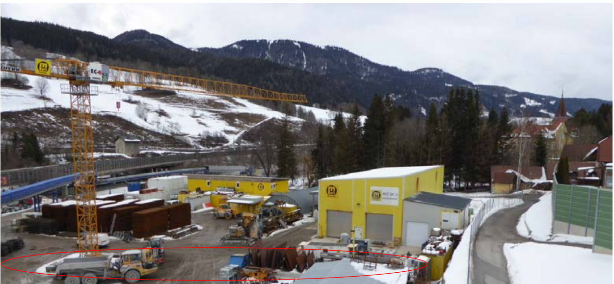
E3 - Blick vom Infoblick Grautschendorf Richtung Nordosten
